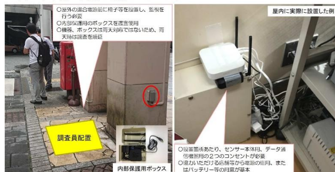
図 2-6 Wi-Fi センサーの設置状況
