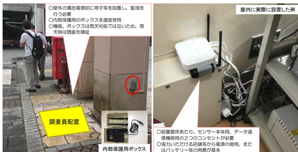
図 3-19 Wi-Fi センサーの設置状況
