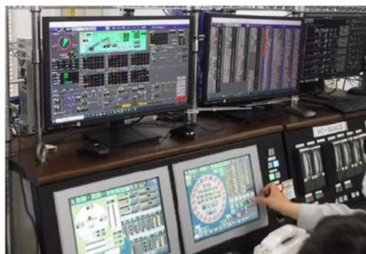
シールドマシン中央制御室
