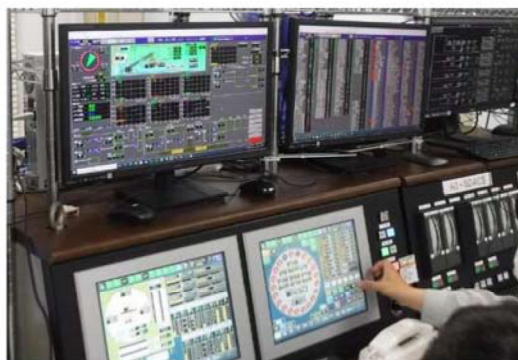
シールドマシン中央制御室
