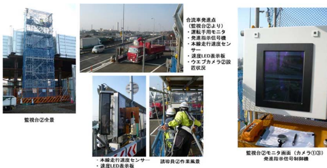
図 3-51 監視台②の現場設備状況
